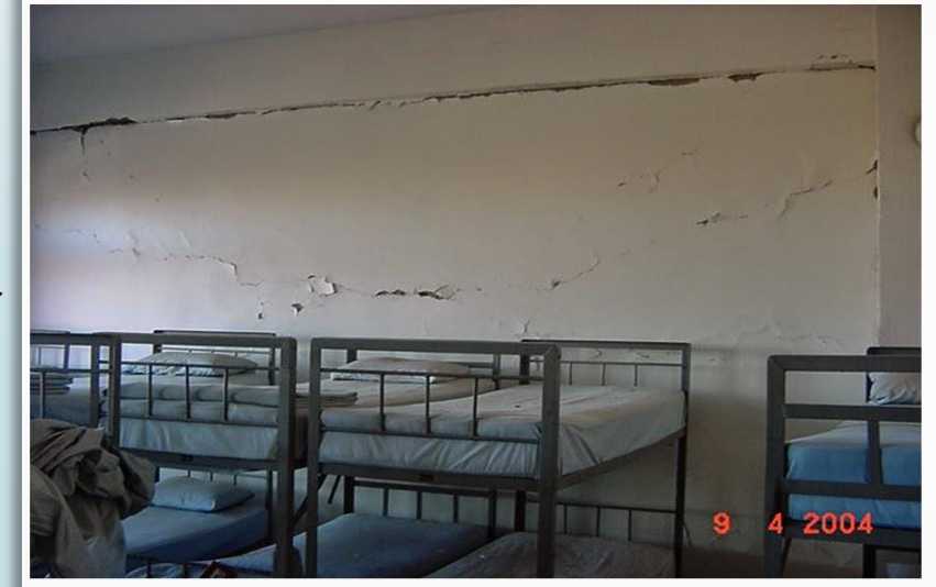
Dolgu Duvar ile Taşıyıcı Çerçeve Arasındaki Sıva Çatlağı
