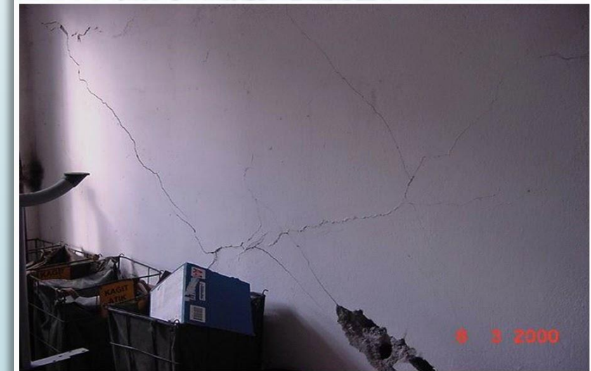
Dolgu Duvar Sıva ve Duvar Hasarı Başlangıcı
