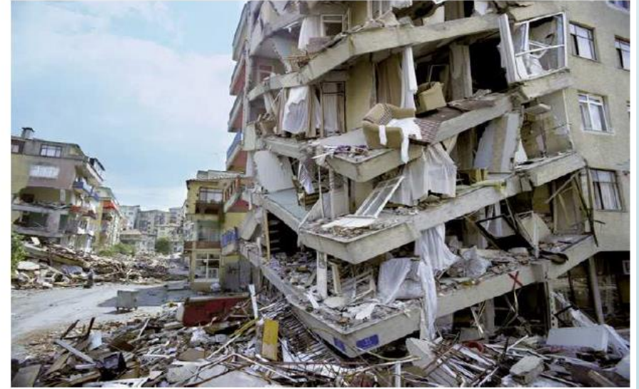
Köşe kolon hasarı
