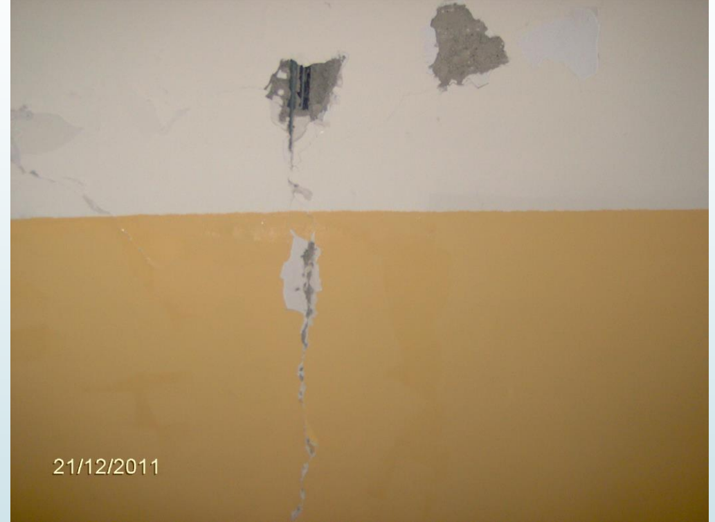
Elektrik ve mekanik tesisatların döşendiği yerlerde çatlak oluşumu, Van
