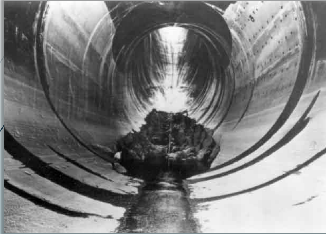
Kavitasyon hasarı Karun Barajı, Iran
