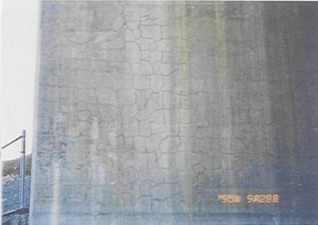
ASR Hasarına Uğramış Köprü Ayağı (İzmir)
