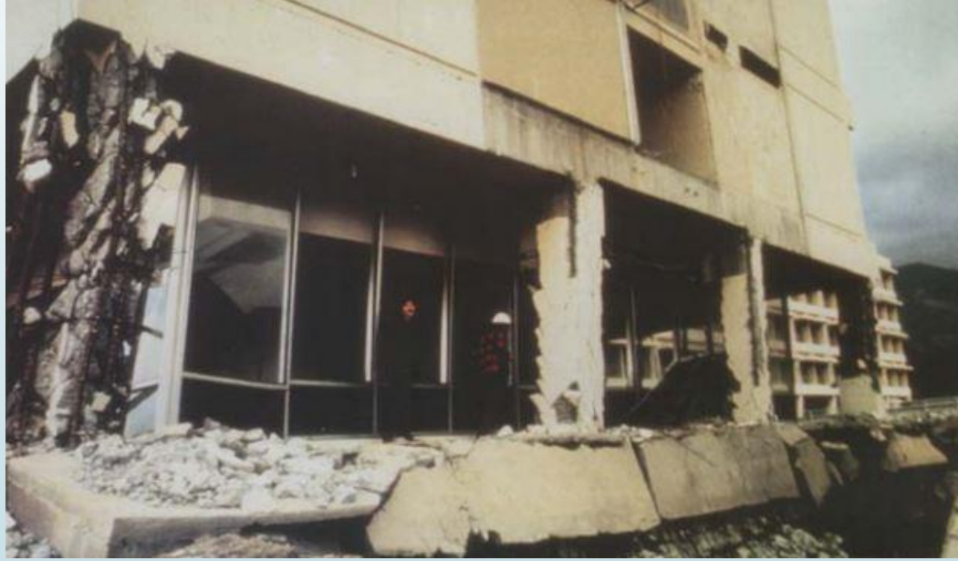
Olive View Hastanesi zayıf kat hasarı (9 Şubat 1971 San Fernando - Kaliforniya Depremi, M = 6.5 )
