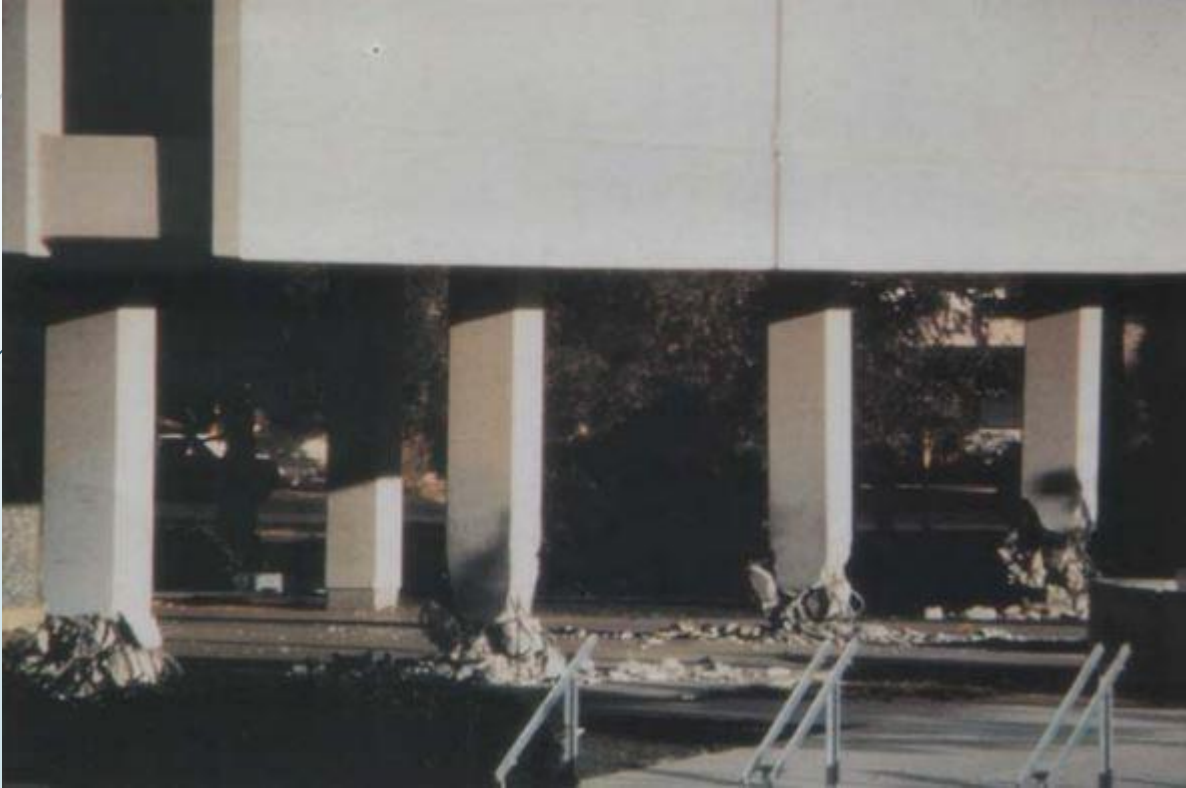
Imperial County Belediye Binası zayıf kat hasarı (15 Ekim 1979 Imperial County Depremi, M = 6.4 )
