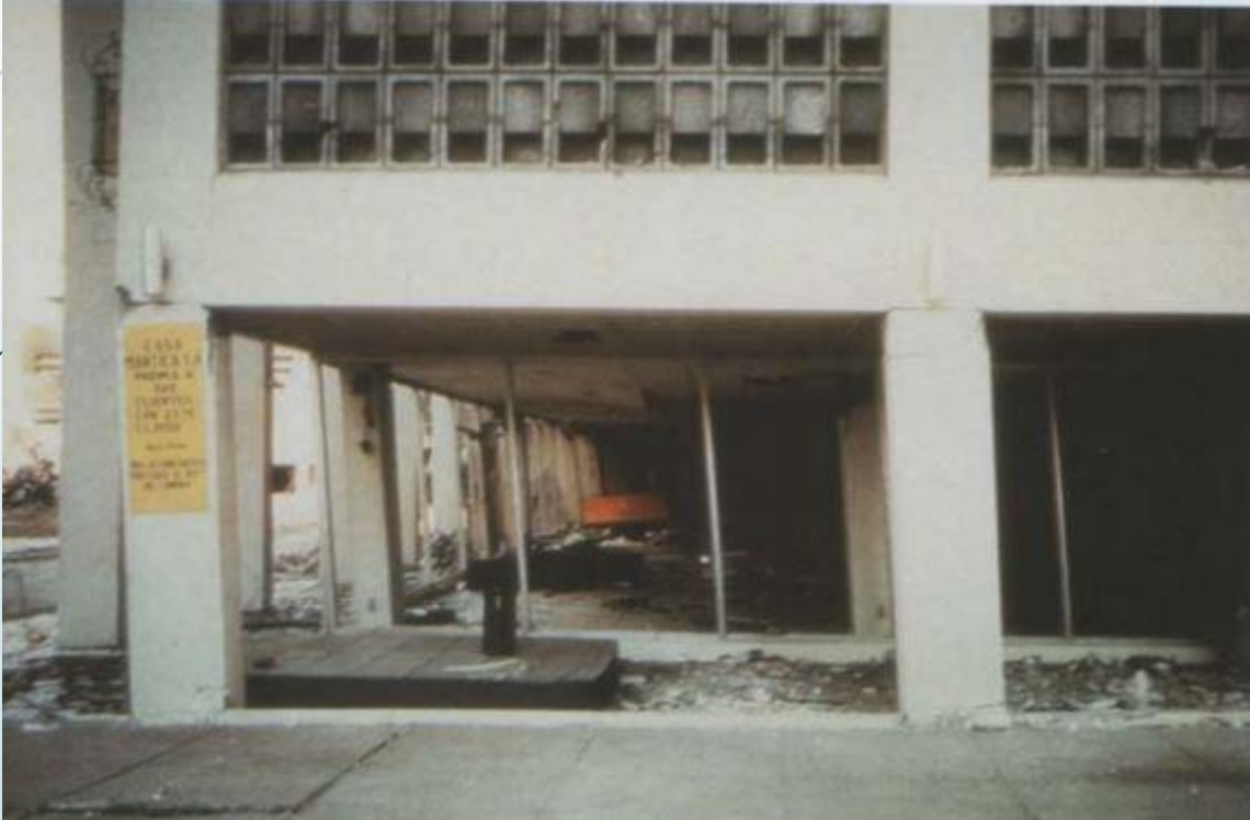
Casa Micasa Binası zayıf kat hasarı (23 Aralık 1972 Managua - Nicaragua Depremi, M = 6.2 )
